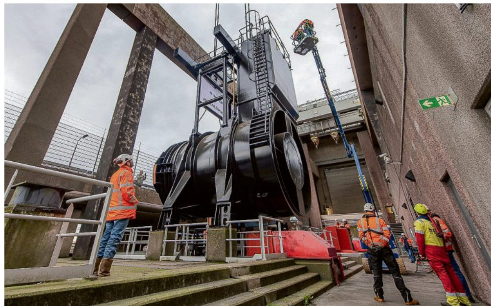
Fünf Flügel und ein Rotor der Weltrekord-Pumpe im niederländischen Ijmuiden sind beim Metallwerk Kleinken in Dorsten gefertigt worden. Die Pumpe wird derzeit eingebaut. FOTO NIJHUIS PENTAIR
